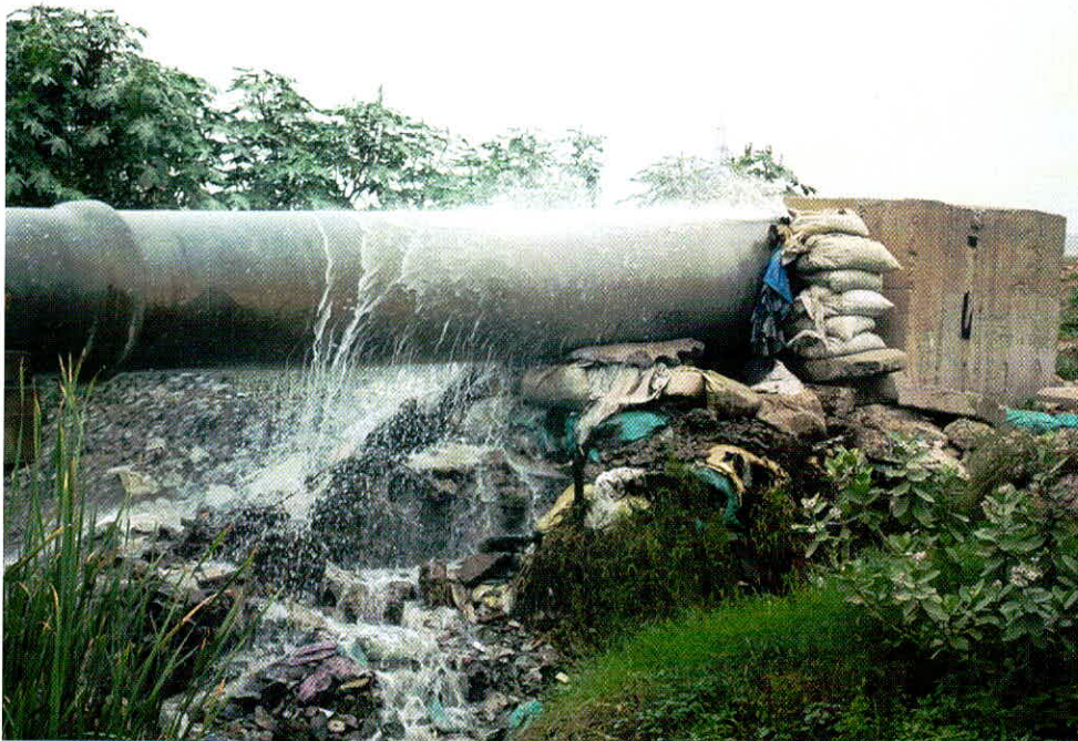
फटे पाइप लाइनों की मरम्मत जरूरी है
